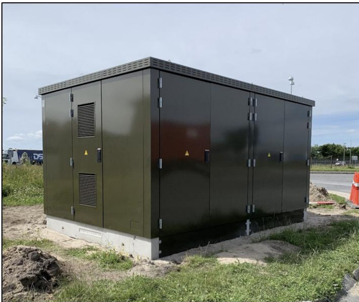
Figur 10 Eksempel på prefabrikkert nettstasjon
